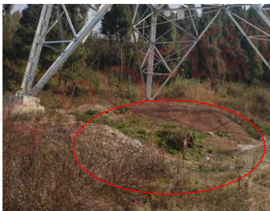
图7-11 未清理建筑垃圾
